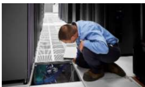
Figura 1.29. Piso elevado de um Data Center . Disponível em: https://tinyurl.com/3ujek7rz . Acesso em: 12/07/2023.
