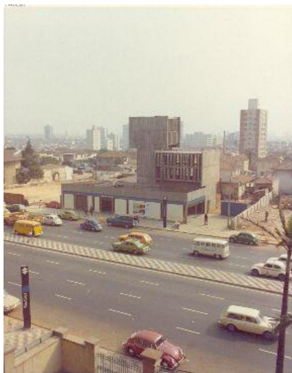
Figura 33 - Estação Santa Cruz em relatório de acompanhamento de obras civis da Linha 1–Azul na década de 1980.
