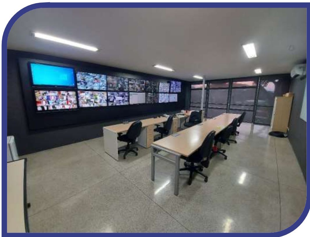
Figura 26 - Sala de Monitoramento
