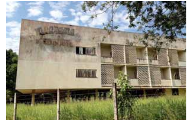
Figura 4: Ruínas do Hotel Umuarama, em Ribeirão Preto. Projeto da década de 1960, do engenheiro Hélio Fóz Jordão. Exemplar modernista abandonado. Fonte: Acervo de Larissa França Peres (12/2013).
